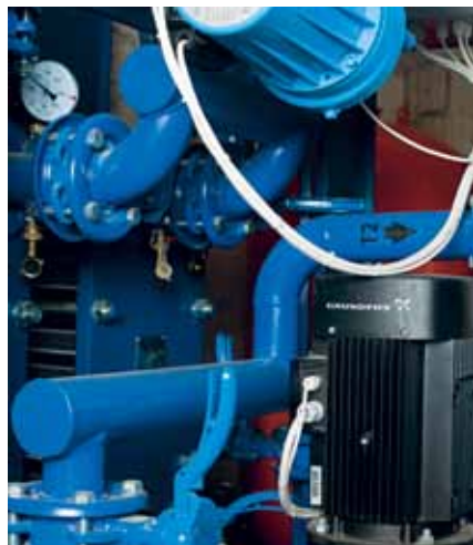
Новое технологическое оборудование в только что реконструированной школьной котельной в г. Березань.
